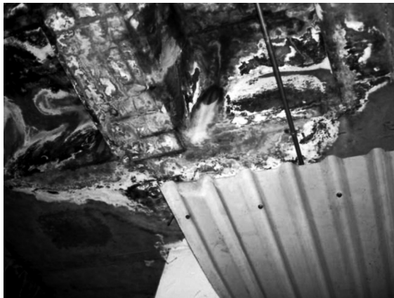
Foto 7. Aspecto de deterioro que presenta la losa de cubierta del estacionamiento ubicado dentro de la Plaza Ángel María Garibay
